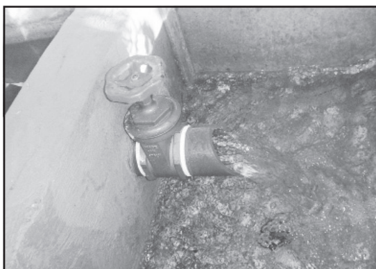
Η νέα μεταλλική βάνα διανομής νερού
